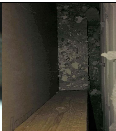
Kuva 7. Tilan 204.1 vanhassa ulkoseinässä ei ollut lämmöneristettä. Ulkoseinä on muutettu väliseinäksi. (R3, VS).
