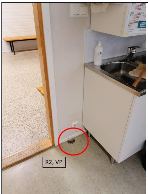
Kuva 5. Lattiapäällysteestä otettu näyte tilassa 229. Mustassa liimassa oli antofylliittiasbestia.
