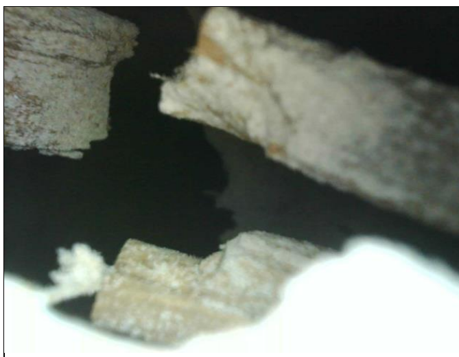
Kuva 6. Vaurioituneelta näyttävää puumateriaalia korokerakenteen sisällä (R1 VP).
